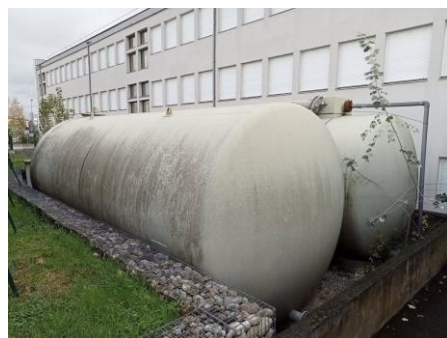
Réservoirs d'eau pluviale (© Julien Ducaroy)
