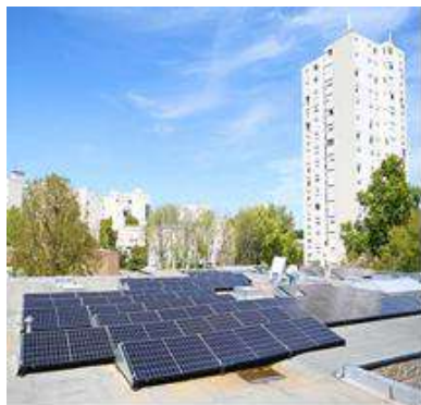
Panneaux photovoltaïques de la Ville © Dalila Bouguelmouna
