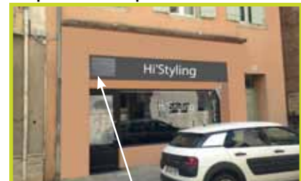
Climatiseur intégré derrière le panneau de l'enseigne
